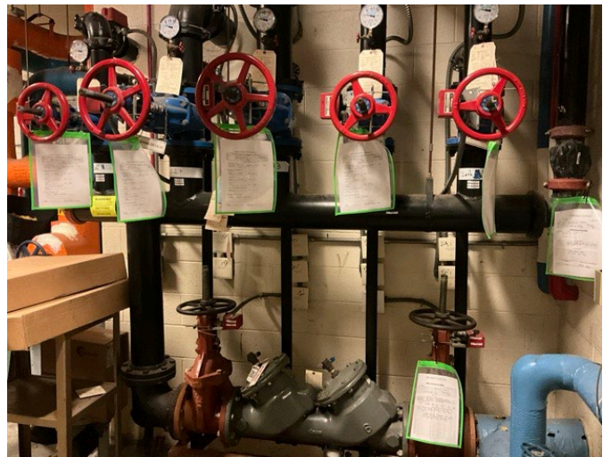
28 - FIRE SPRINKLER RISERS
